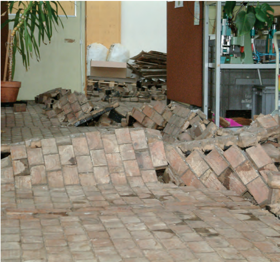
UNFASSBAR: Der Boden wurde durch das Wasser komplett zerstört (2003/2004).
